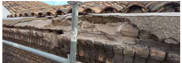
Alero con desprendimientos significativos y ladrillos faltantes.
