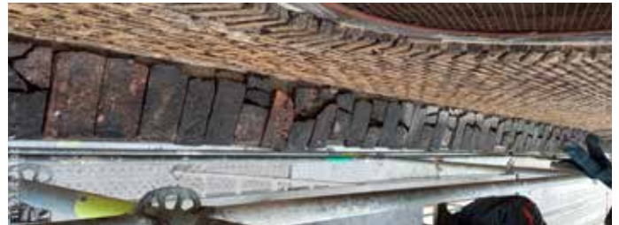
Baldosas sueltas que, sorprendentemente, no se han desprendido.
