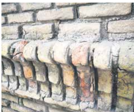
Ladrillos en mal estado y con riesgo de desprendimiento.
