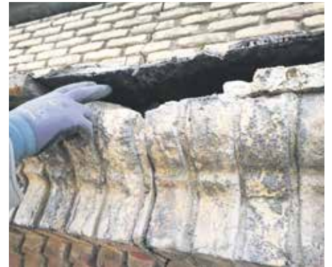
Alero con la protección superior de ladrillos desaparecida y que genera filtraciones.
