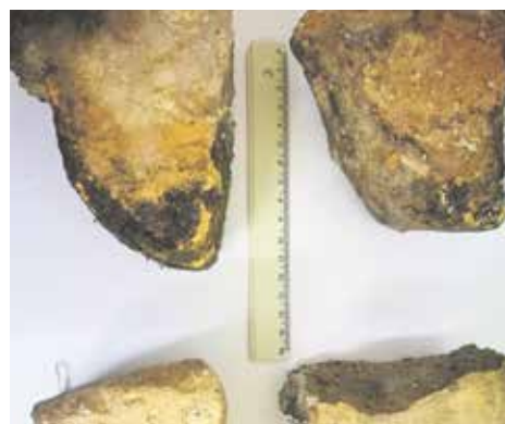
Algunas piezas desprendidas de la fachada de paseo de la Constitución.
