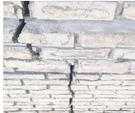
Grieta de 70 cms. de profundidad que atraviesa toda la fachada. Se va a sellar, grapar y coser.
