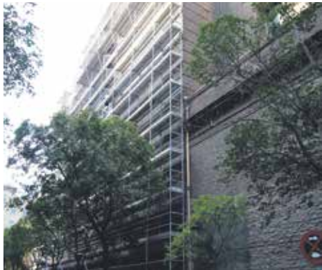
Fachada de d. Hernando con andamios. Esta es la primera de las tres fases.
