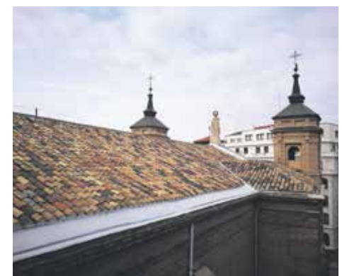
Estado actual del tejado con más de varios cientos de tejas sustituidas o recolocadas.
